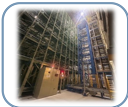
完全自動で 製品の搬送が可能な 完全自動倉庫
